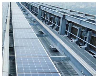
屋上に設置された太陽光パネル
