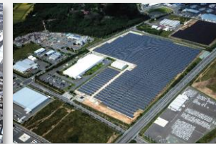
八戸太陽光発電所
