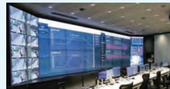
中央監視室/Central Control Room
