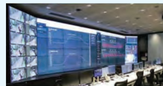
中央監視室/Central Control Room
