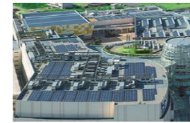
「ららぽーと柏の葉」屋上の太陽光パネル
