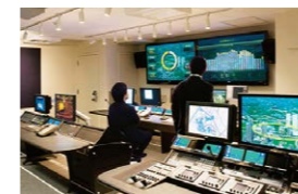
地域のエネルギーを見守る「柏の葉スマートセンター」
