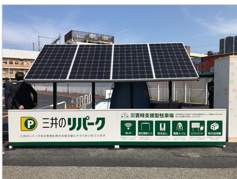
「『三井のリパーク』みなとまち新潟駐車場」のハイブリッドソーラーシステムの太陽光発電パネル
