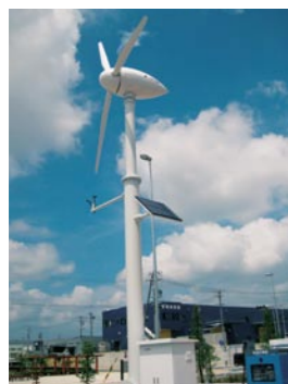
ららぽーと磐田の風力発電機 (小型太陽光発電機付き)
